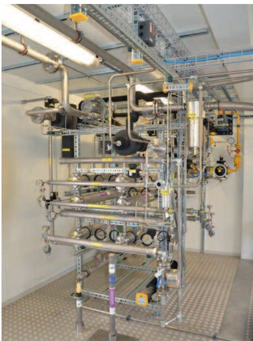
Installation de traitement du biogaz à la STEP de Reinach, 35 m 3 /h.
