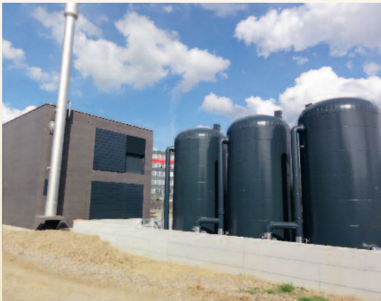
Tranche 1 Centrale de chauffage et accumulateur de chaleur
