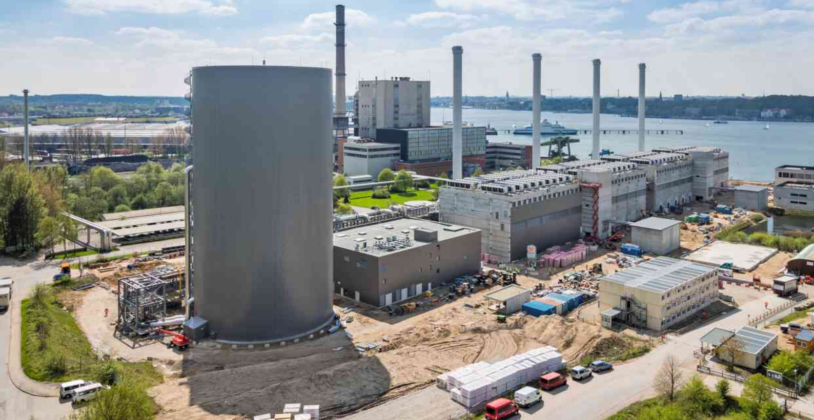
Zu einer richtig grossen WKK-Anlage gehört auch ein grosser Wärmespeicher: Neubau Gasmotoren-Kraftwerk der Stadtwerke Kiel, Norddeutschland ( www.stadtwerke-kiel.de ): 190.4 MW el Nettoleistung, 192 MW th Wärmeleistung. Der Wasser-Wärmespeicher beeindruckt: Ø 31.2 m, 60 m hoch, 30 000 m 3 nutzbar, Kapazität über 1500 MWh bei Betrieb im Bereich 60-115°C. (Referat Klaus Payrhuber, GE Jenbacher GmbH)
